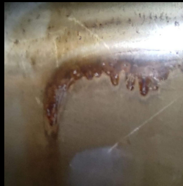
сожженные химией плитка, нержавейка
