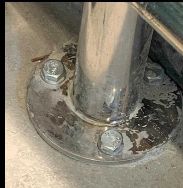
грязь в труднодоступных местах
