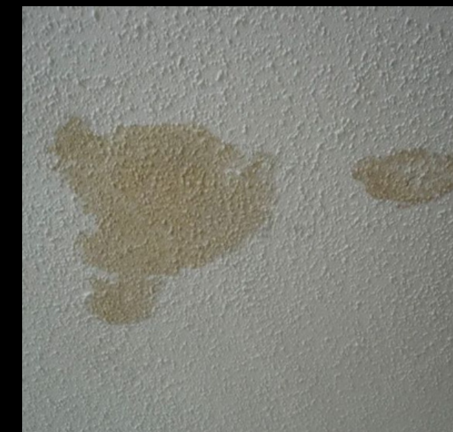
пятна от химии на штукатурке/ обоях
